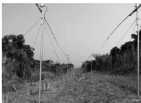
対島海洋レーダー受信アンテナ
